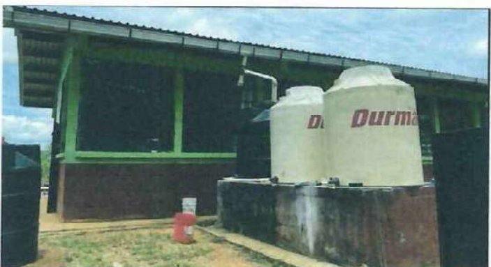
Foto 3: TECHO DE CORREDOR PARTE DE ATRÁS DE ESCUELA, EL CUAL SE USA PARA LAVAR .
