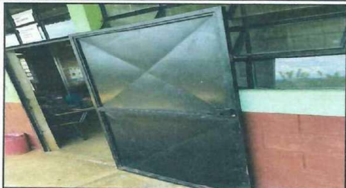
Foto1: SUSTITUCION DE PUERTAS , DEBIDO AL DETERIORO DE LAS CHAPAS Y CORRION.
