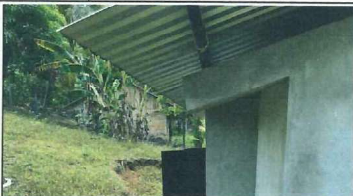
Foto 2: TECHO DE CORREDOR DE BAÑO: NO HAY SUFICIENTE SOMBRA PARA CUBRIR POR LA LLUVIA
